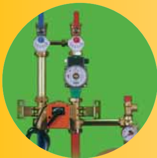
Circuitos de calefacción controlados en función de las condiciones climáticas
